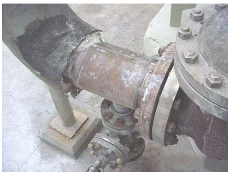
Fig. 3.5: Situação que oferece riscos - integridade mecânica da tubulação comprometida (banco de fotos DSRB)
